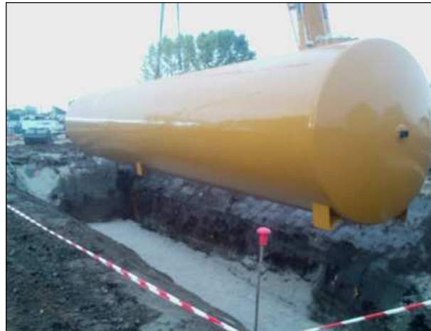
Lycée des métiers de Bergerac - cuve de 120 m 3 (photo : Eiffage)
